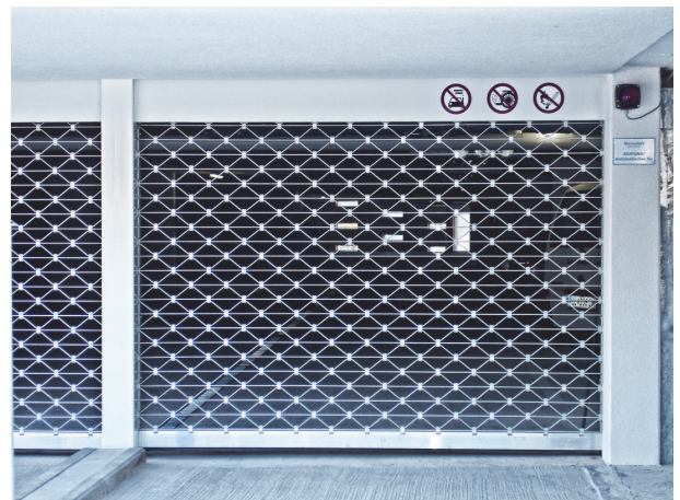
Tiefgaragen-Rollgitter im Einzelfall bereits mehrfach als Rettungsweg zugelassen
